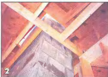
Прохождение трубы вблизи элементов каркаса. Во всех правилах определяются минимальные зазоры между горючими строительными материалами и камином либо дымовой трубой. Для внутренней дымовой трубы, подобно этой, предусмотрен зазор не менее 50 мм
