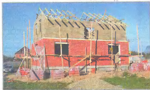
Промежуточный этап строительства. Стены дома на цоколе из бетонных блоков возведены без применения подъемных механизмов. Первый этаж по теплоизоляции облицован кирпичом
