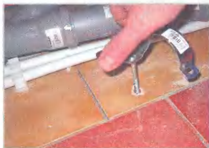
Кронштейны для установки канализационных труб надежно крепят к полу ванной комнаты. Устанавливать их надо с уклоном, чтобы обеспечить хороший сток воды в общую канализацию
