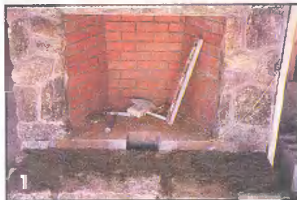
Выход воздухопровода в камине. Правила некоторых штатов требуют, чтобы все камины имели систему внешней подачи воздуха для горения. Она обычно состоит из воздухопровода, который идет к передней части пода
