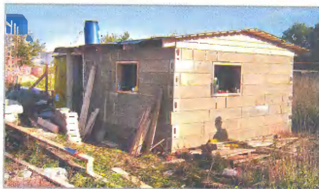
Строительная бригада в первый день работы сложила для себя бытовку, не применяя вяжущий раствор. Ее впоследствии можно легко разобрать
