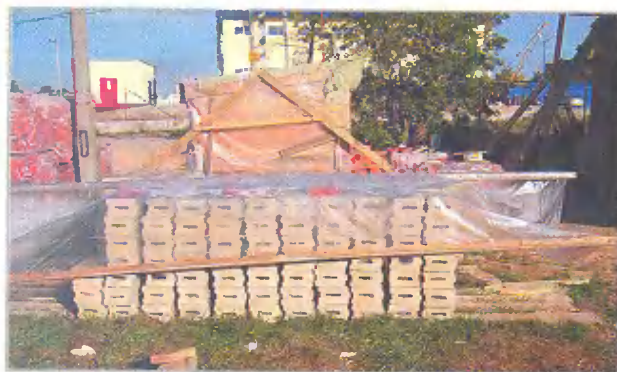
Доставленный на строительную площадку материал был складирован и защищен от осадков полиэтиленовой пленкой
